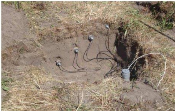
Sondes Thetaprobe après installation dans l'une des stations SMOSMANIA, à 4 profondeurs (5,10,20,30cm).
